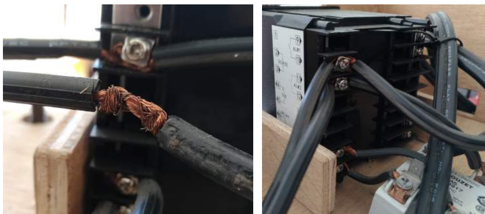
(図 44)ヒートプレスの220V 高圧部の結線の様子
