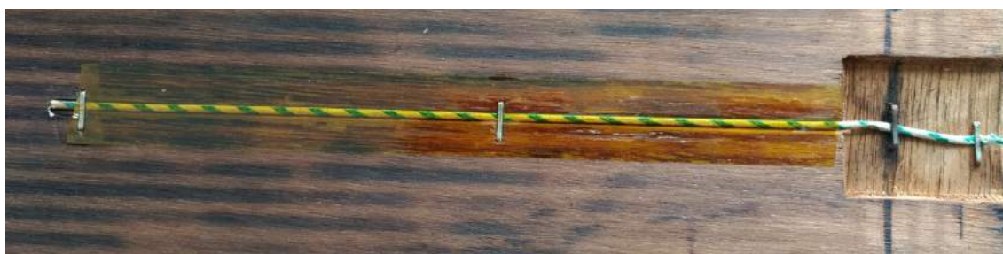
(図 17) タッカー(建築用ホチキス)での乱暴な取り付けによる熱電対温度センサ
