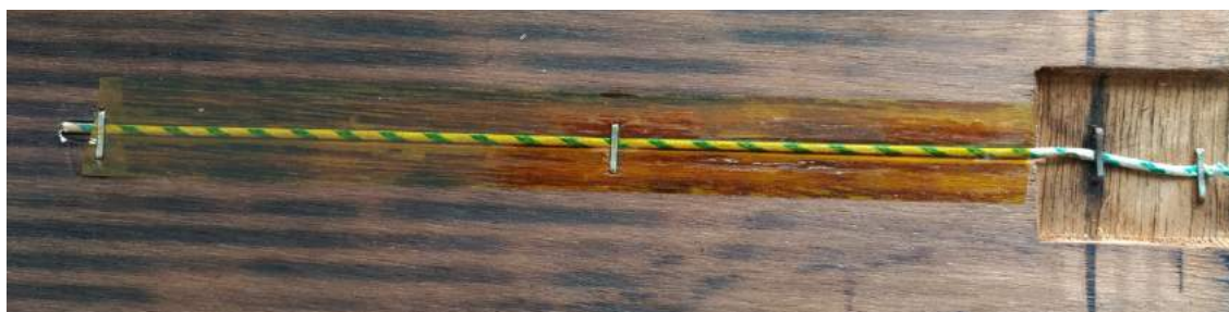
(図 17)タッカー(建築用ホチキス)での乱暴な取り付けによる熱電対温度センサ(再掲)
