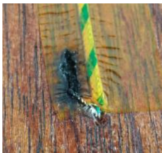
(図 15) センサで傷ついて発生した スパークの跡
