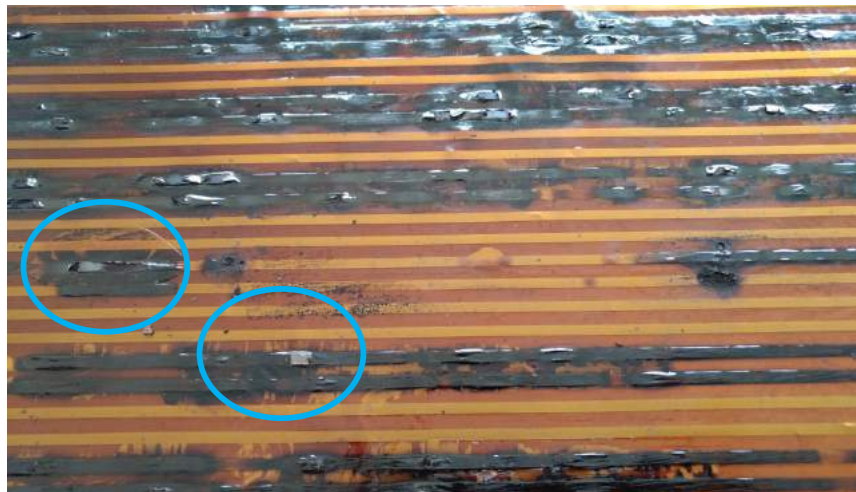
(図 13)ヒーター焦げ部:青○部は被覆が破れ熱線が露出。ヒート面の鉄板と接触し漏電していたことが推測される
