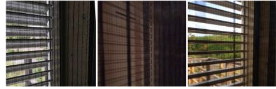
コエボハウスに設置されている屋外電動ブラインド
